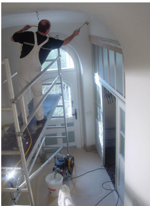
2 Im Malerbetrieb von Horst Hubka – hier selbst im Einsatz – ist die maschinelle Verarbeitung von Farben im Innenbereich an der Tagesordnung. (Foto: Hubka)
