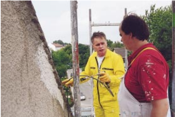
4 Beschneidarbeiten erfordern neben einer richtigen Einstellung der Maschine und Wahl der richtigen Komponenten auch eine ruhige Hand. Beim Dachabschluss konnte damit an dieser Giebelseite auf das Abkleben verzichtet werden.
